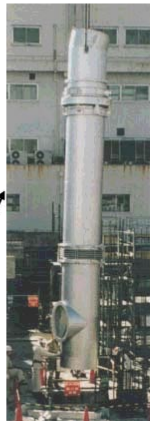
建設時の煙突免震継手
